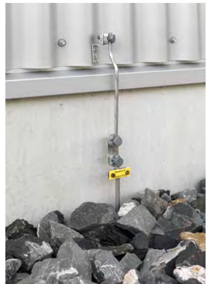
Trennstelle an Erdungs-System
