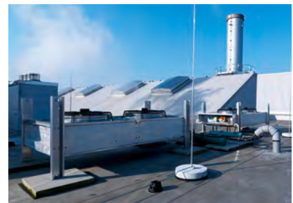
Isolierter Blitzschutz an Dachaufbauten
