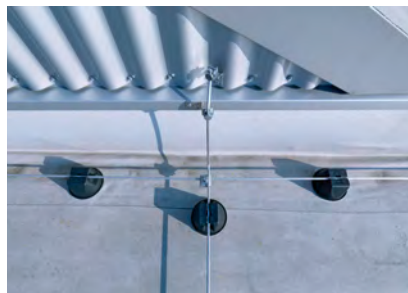
Anschluss der Metallfassade an das Blitzschutzsystem
