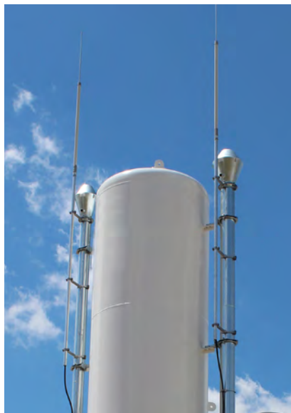
isCon®-System im Ausblasbereich einer Biogasanlage
