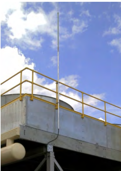
Isoliertes Ableitungssystem im explosionsgefährdeten Bereich
